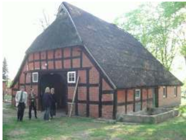
Sanierungsbedürftiges Bauernhaus in Schleeßel
